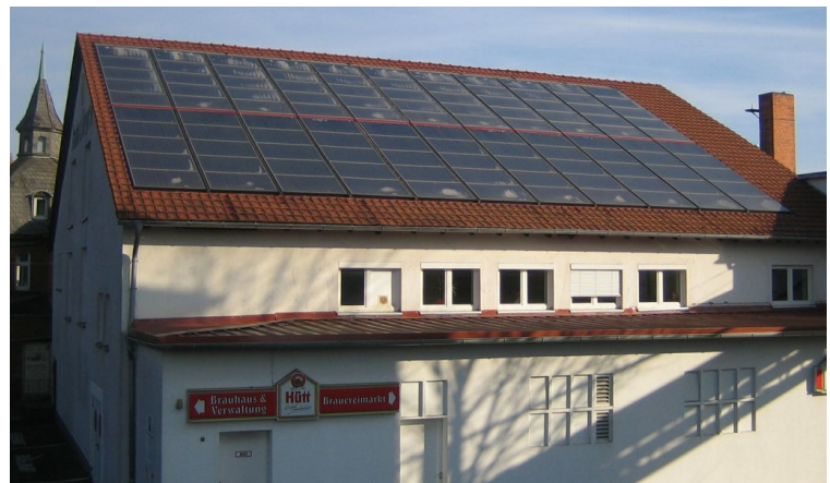
Solarthermische Wärme in der HÜTT Brauerei Kassel, 2011
