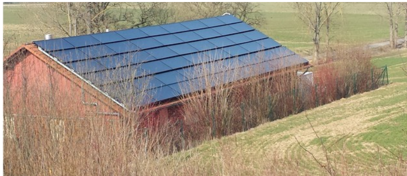
GDR A Neu-Eichenberg, 155 m 2 Solarkol. und 120 kW Gas-WP, 2015
